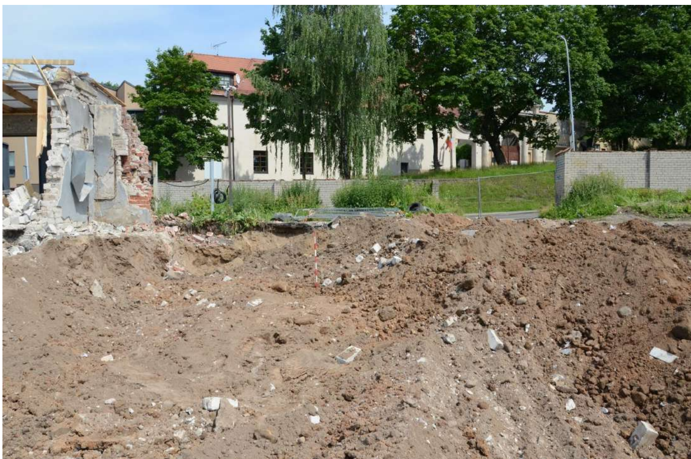
4. Žvalgymai Š, ŠR sklypo dalyje demontuojant garažus ir nuimant asfalto dangą. Vaizdas iš R.
