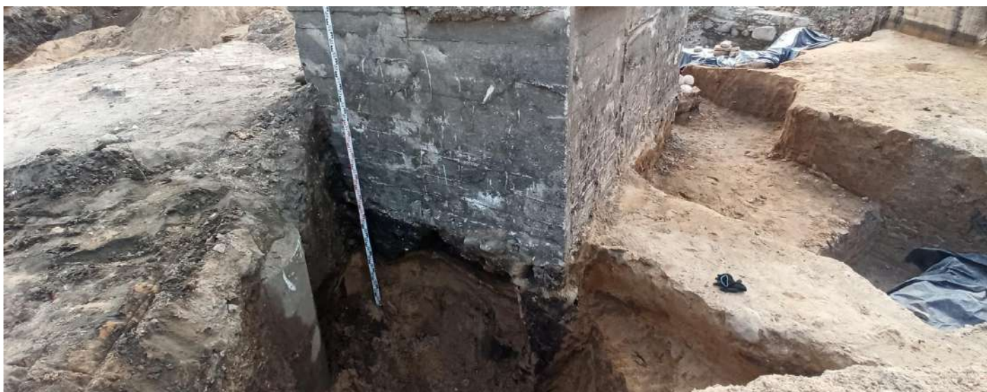
345. Perkasa Nr. 14 – XX a. įrengtas šulinys ir garažo duobės konstrukcija (2,4 m gylis). Vaizdas iš V.
